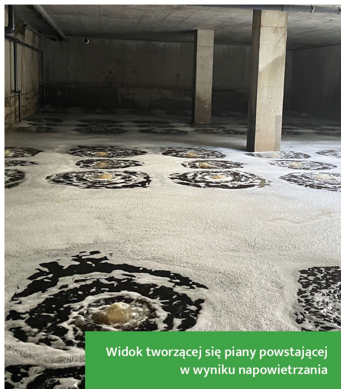
Układ napowietrzający w trakcie pracy
